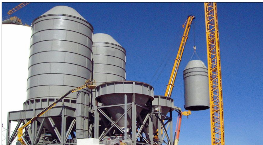
Ilustración 2: Silos en Acero Estructural, a la izquierda, Ceniza Volante, de mayores dimensiones. A la derecha y en montaje, Escoria.
