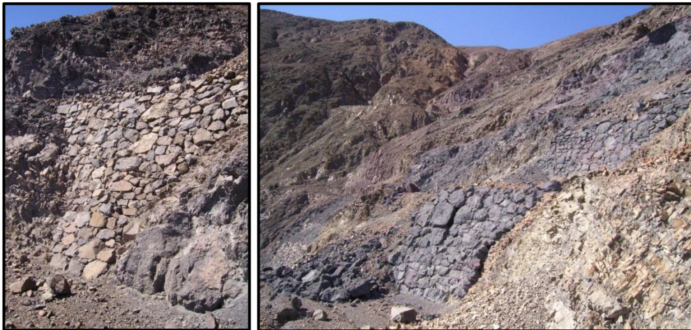
Figuras 26 y 27: Detalle de muro de contención al aproximarse a la curva de retorno de las Franjas 4 y 5 (izquierda). Serie de muros de contención y retención cubriendo un área de cárcavas entre las Franjas 5 y 7 (derecha) del Segmento 3.
