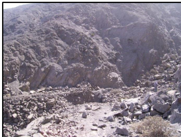
Figura 24: Detalle de corte del camino por quebrada secundaria y arrastre de material en el punto de unión de los Segmentos 2 y 3.
