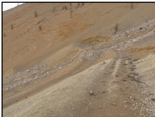
Figura 22: Detalle de corte por aluvión y arrastre de ripios en el extremo norte (curva de retorno) de las Franjas 10 y 11 del Segmento 1.
