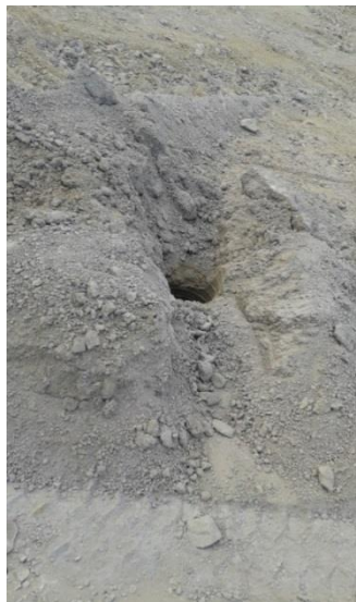
Ilustración 33: Caída de material en pozo por tránsito de equipos
