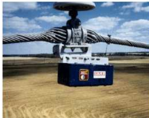
Ilustración 2.7: Sistema de monitoreo para vibraciones de alta frecuencia [3].
