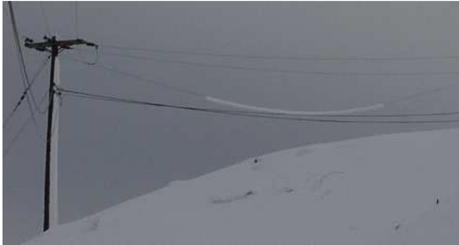
Ilustración 2.14: Línea afectada por acumulación de nieve.
