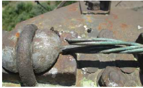
. Ilustración 26.3: Cable de guardia por cortarse, inspección con trepado.
