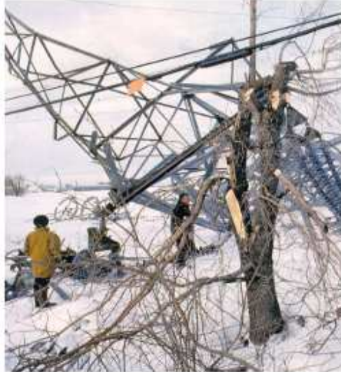
Ilustración 2.10: Efecto galloping sobre torre de alta tensión [3].
