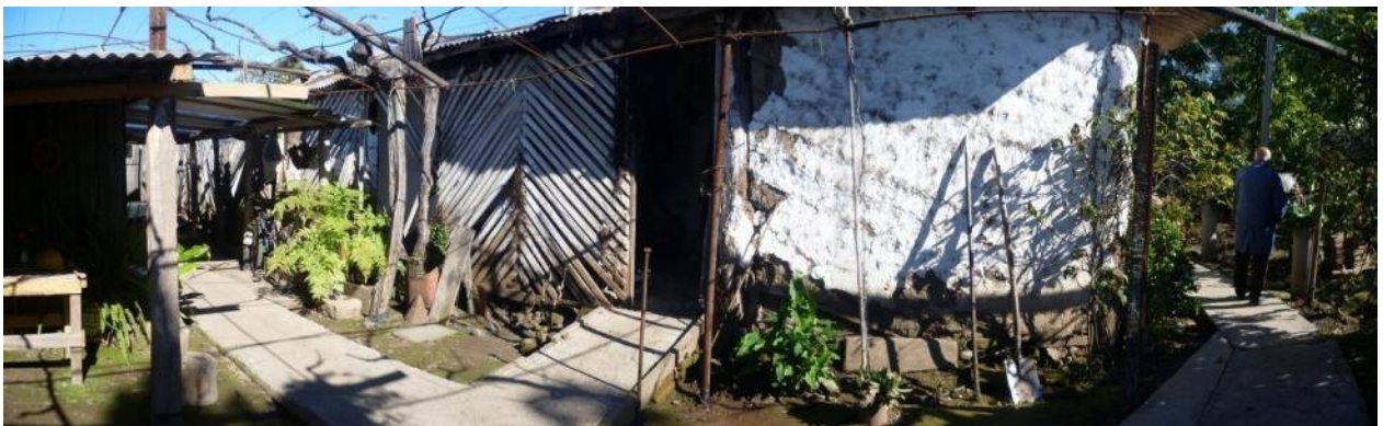
Figura 22: Fotografía de la casa de uno de los entrevistados, tomada con posterioridad al terremoto de 2010. En ella se muestra una adición en quincha, hecha al módulo inicial de adobe.
