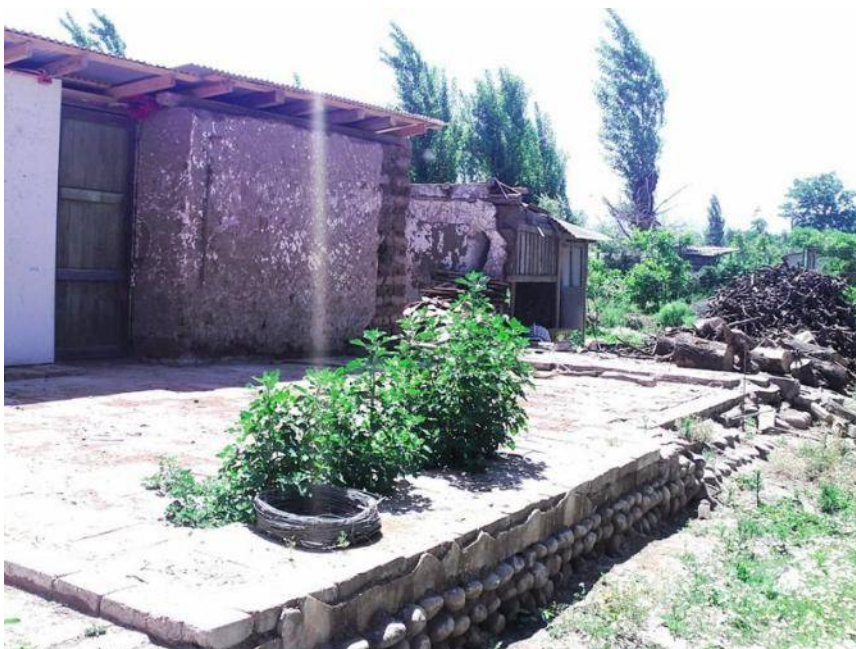
Figura 44: Fotografía de cimientos de casa de uno de los entrevistados, tomada con posterioridad al terremoto de 2010, cuando sus dueños decidieron demoler lo que había quedado en pie de la construcción original de adobe.
