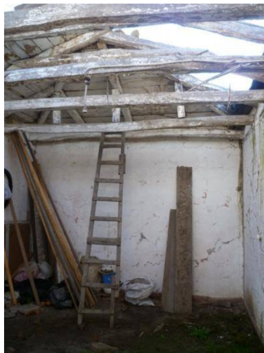
Figura 42: Fotografía de tijerales en casa de uno de los antiguos inquilinos de la Hacienda San José del Carmen, El Huique, tomada con posterioridad al terremoto de 2010. Fuente: Archivo propio.
