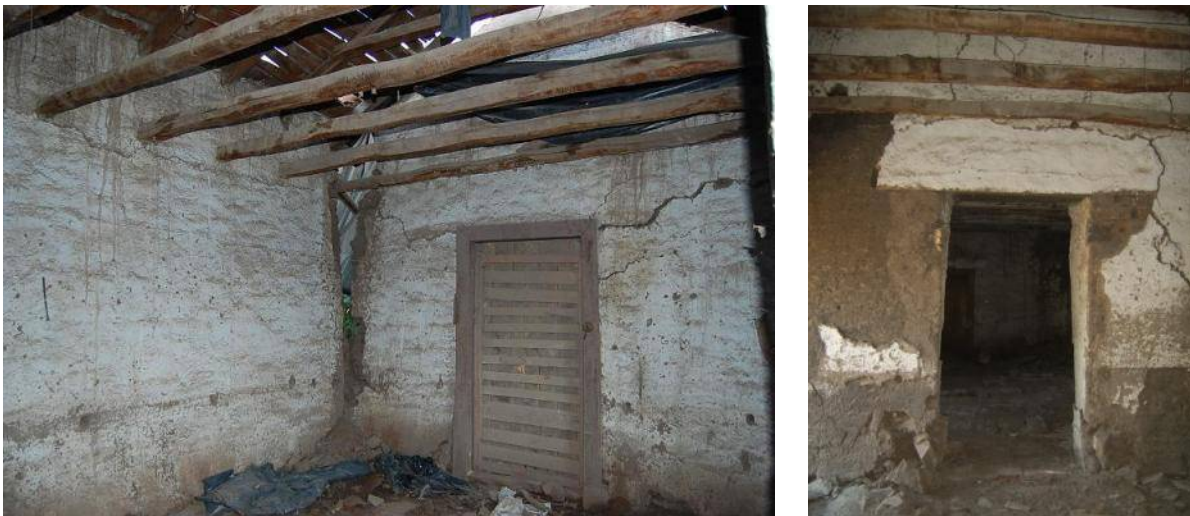
Figura 65: Fotografías de daños acumulados (fallas verticales, horizontales, diagonales; desprendimiento de material y desaplomo de muro; pérdida de tejas de cubierta; etc.) en una de las casas de antiguos inquilinos de la Hacienda San José del Carmen, El Huique. Se trata de una vivienda que no estaba siendo habitada al momento del terremoto de 2010. Su dueño habitaba una vivienda de emergencia desde que una inundación varios años antes dejó su casa gravemente afectada.
