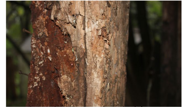
2-3-4. Pilares y tabiquería con patologías de xilófagos.
