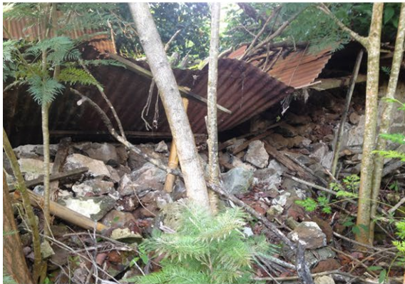
6.1 Muros derrumbados en edificación de comedores
