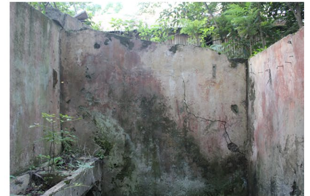
5.2 Muros de mampostería con patologías de hongos en vanitorios
