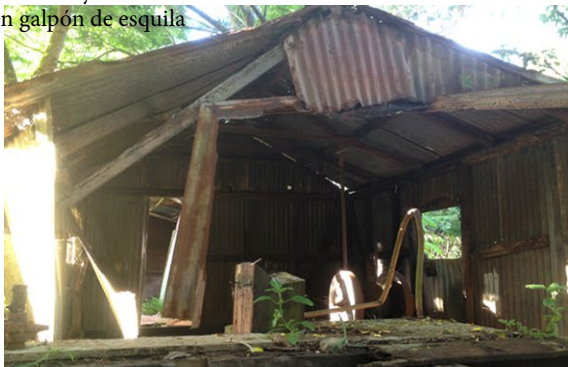
3. Pilares y revestimientos lesionados en sala de motor
