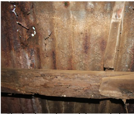
4. Planchas de zincalum oxidadas en todas las edificaciones
