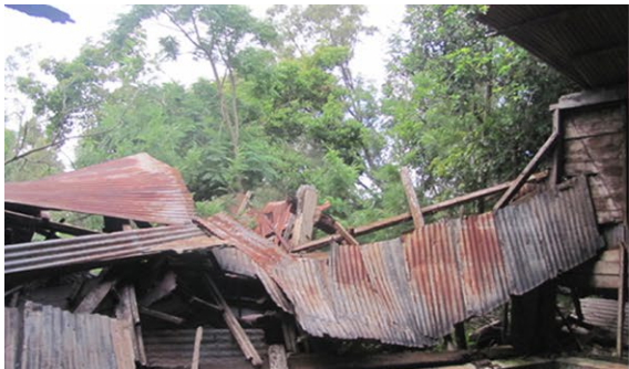
2. Pilares y revestimientos de madera totalmente destruidos en galpón de esquila
