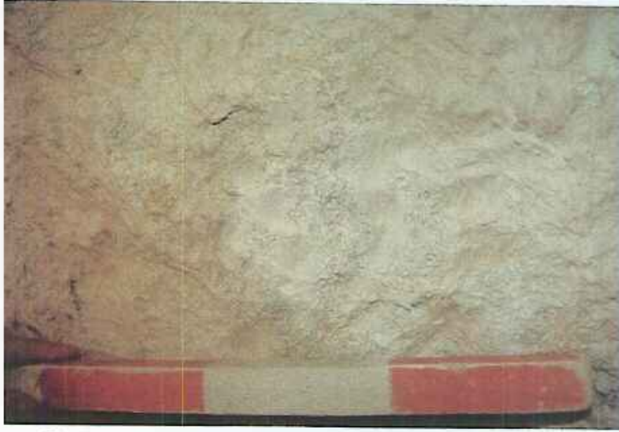
Figura 42: Negativo de los impactos con posibles cinceles sobre las paredes de la mina indígena (AB-39). Foto obtenida del Pique 3.
