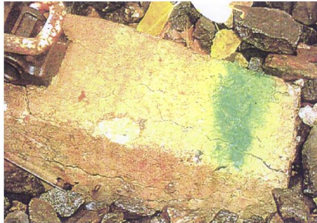
Figura II-24. Agrietamiento del extremo del durmiente (Sahu & Thaulow, 2004).
