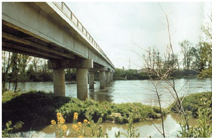
Figura II-16. Vista general de un puente con una viga transversal afectada por DEF (LCPC, 2009).
