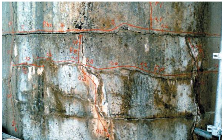
Figura II-17. Agrietamiento multidireccional localizado en la cara vertical, en las extremidades de la viga mostrada en la figura anterior (LCPC, 2009).
