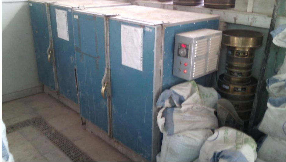
Figura III-13. Horno seco en el cual se lleva a cabo el curado acelerado.
