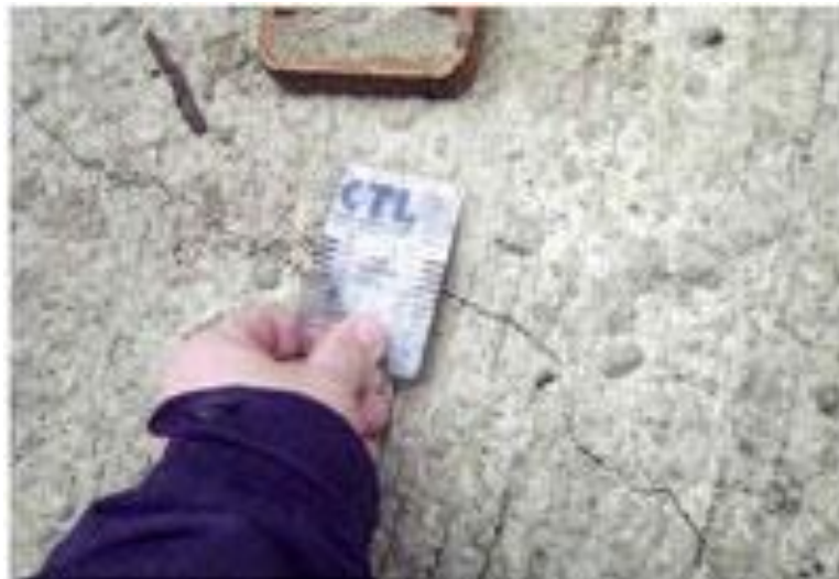
Figura II-5. Agrietamiento térmico (Cement.org, 2015).
