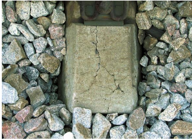
Figura II-15. Extremo de durmiende que muestra una red de grietas causadas por DEF (LCPC, 2009).
