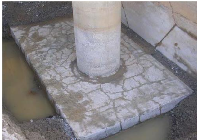
Figura II-10. Agrietamiento de un encepado producto de la expansión del núcleo del elemento debido al fenómeno DEF (NANAYAKKARA, 2011).
