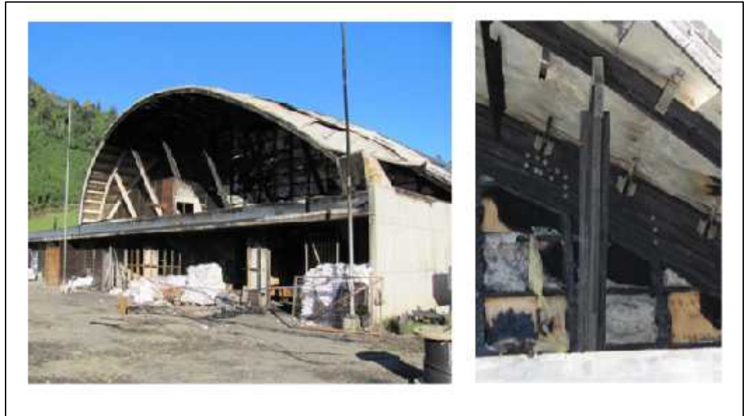
Figura 1.2 “Incendio Planta de Piscicultura Invertek, Ensenada, Puerto Varas, 2011”
