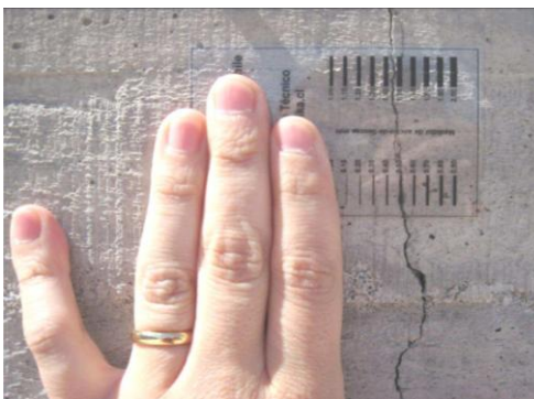
Figura 1-1: Muro de contención afectado por agrietamiento térmico [1]
