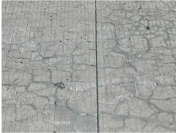
Figura 2-1: Estructura de hormigón dañada por efecto de la formación de etringita tardía DEF. (ndtoolbox.org) [11]
