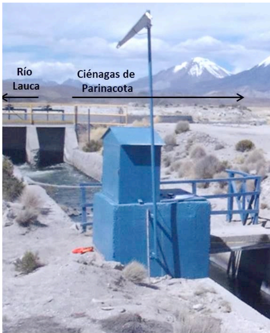
Figura 11-6. Estación de aforo en la bocatoma del canal Lauca. Fuente: elaboración propia.
