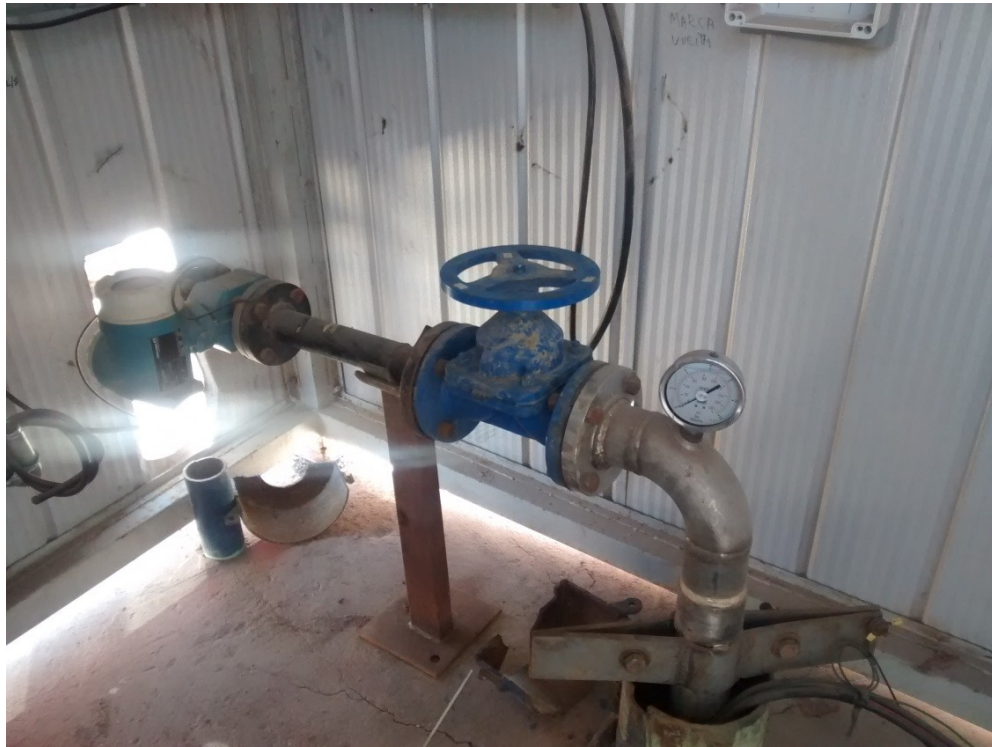
Figura 4.5.1-3 Sistema de habilitación Pozo 1
