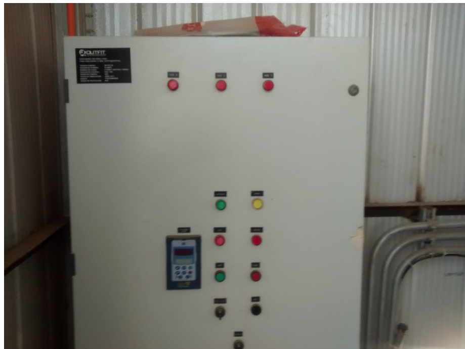
Figura 4.5.1-4 Tablero de Control Bomba Pozo 1
