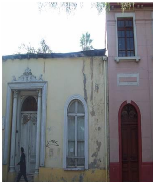
Fig.56: Inmueble deteriorado en el Barrio Yungay, calle R. Sotomayor. Fuente: Autor, 2014.
