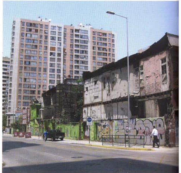
Deterioro de las fachadas en calle Carmen-Santa Victoria, esquina surponiente, año 2010.
