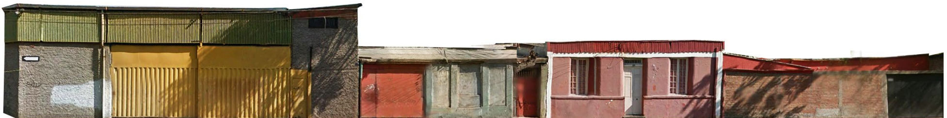
Figura 54 Elevación fachada Oriente en deterioro Fuente: Elaboración Propia
