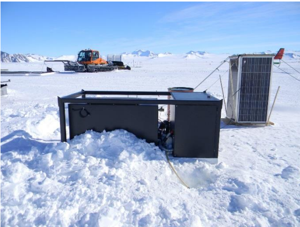
Imagen 39: Generadores eléctricos y Paneles Solares a la intemperie. (Fuente: Coronel Rafael Castillo)
