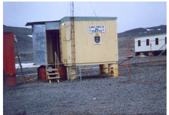
Imagen 23: Módulos deteriorados de la Base TT. Marsh. (Fuente: panoramio.com)
