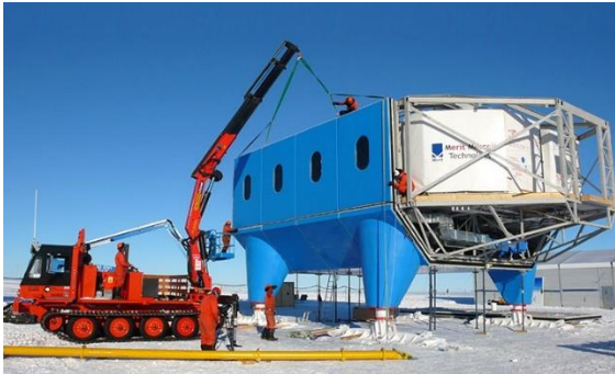
Imagen 64: Armado y montaje de módulos operativos de la base Halley. (Fuente: bas.ac.uk)
