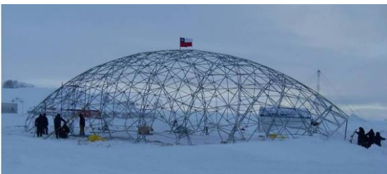
Imagen 79: Instalación de domo geodésico de reticulado doble en la Antártica. (Fuente: 7dias.com.do)
