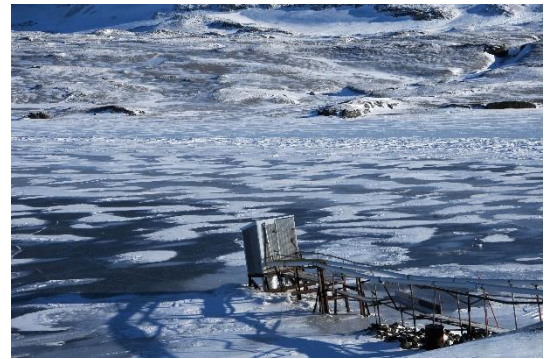
Imagen 22: Sistema de bombeo de agua desde lagos antárticos. (Fuente: uruguayeduca.edu.uy)
