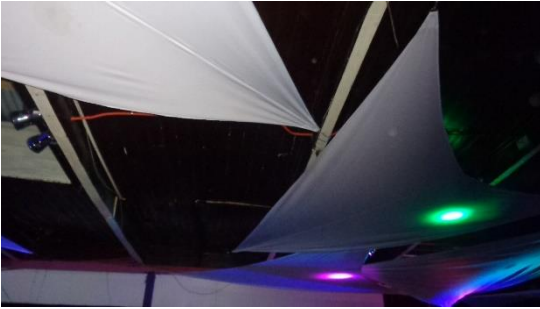
Ilustración D.3.12: Vista inferior del detalle del cielo de la pista del segundo piso con presencia de material combustible como poliuretanos entre otros (cota +0,00 m).
