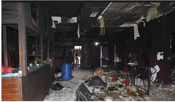
Ilustración 3.1.7.: “Vista desde el interior del recinto hacia la única salida disponible.”
