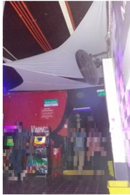
Ilustración D.3.8.: Vista general de pasillo hacia acceso lateral desde pista central – presencia de extintor, señalética, material combustible (poliuretano) en el cielo y desnivel en el suelo (cota +0,00 m).
