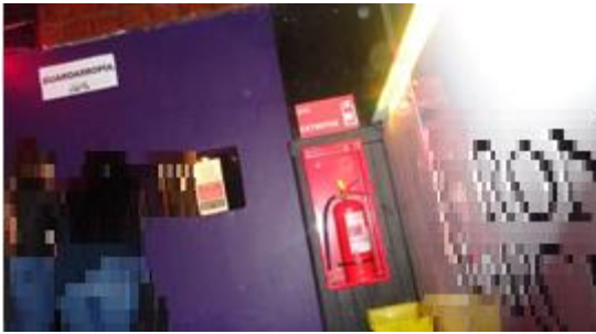
Ilustración D.3.14.: Vista de extintor ubicado en el sector de guardarropía de la pista central (cota +0,00 m).
