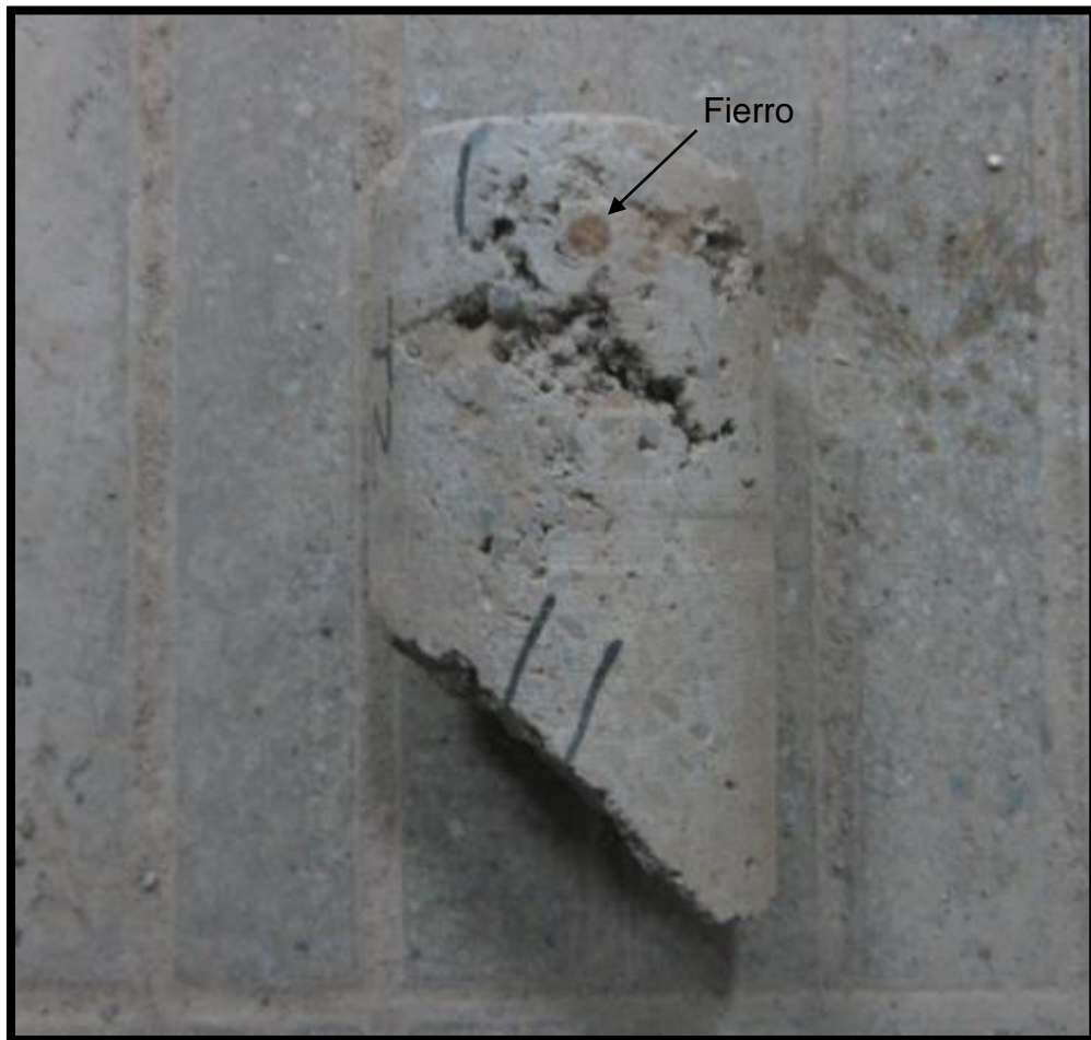
Imagen 3.6: Testigo con armadura y oquedad.
