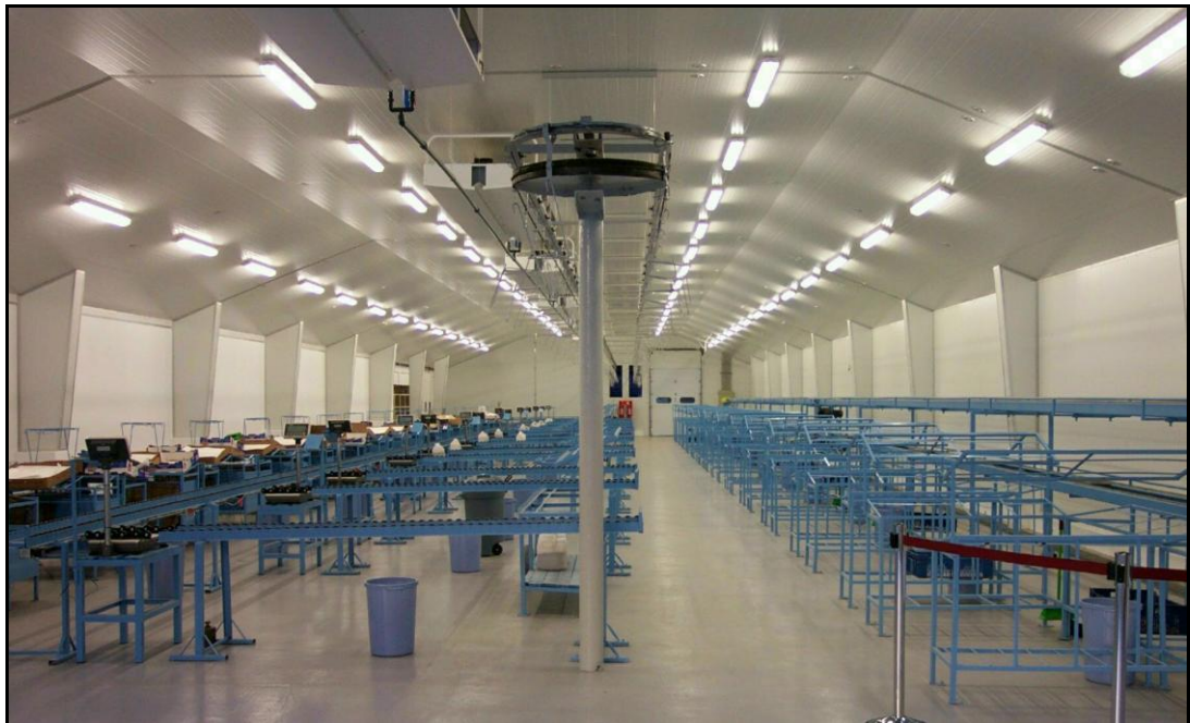
Figura 5.2: Interior del packing climatizado
