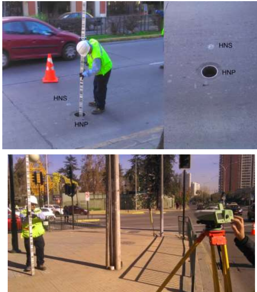
Figura 81: Monitoreo superficial mediante Hitos de Nivelación Superficial (HNS) y Profunda (HNP) (elaboración propia).
