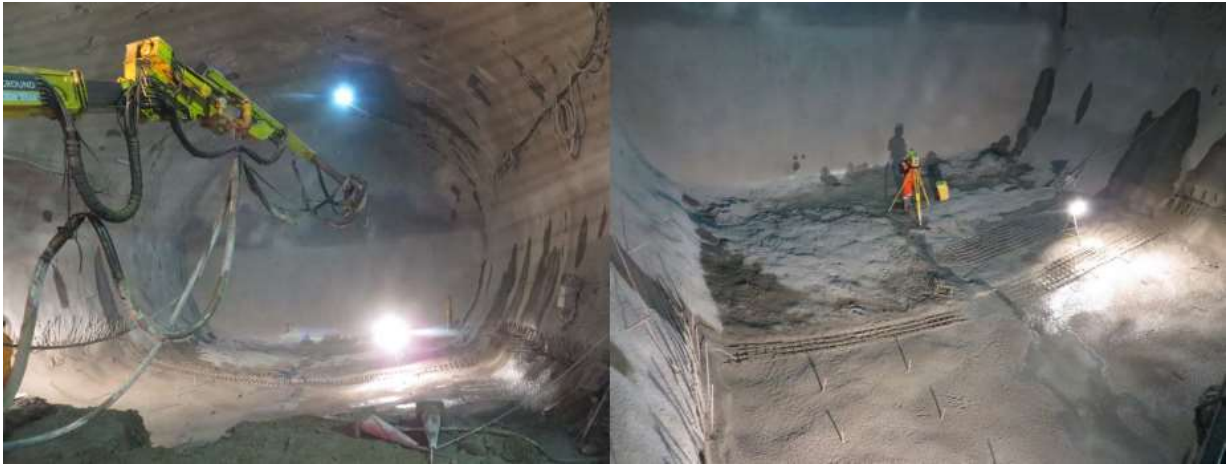
Figura 80: Construcción en retirada de la Contra-Bóveda de la Galería Principal (Velazco, Eduardo).
