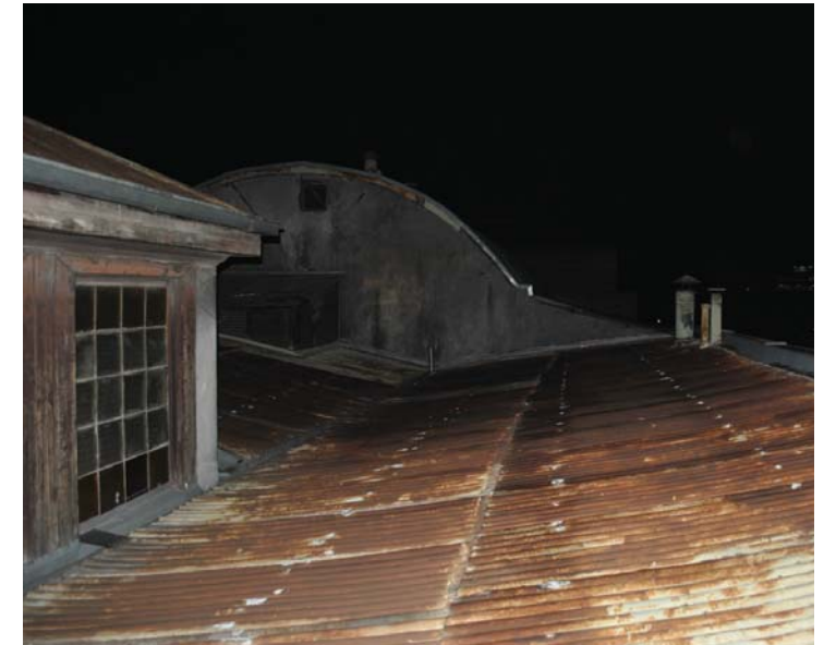
1. Planchas en mal estado, 2. Reposición canaletas
