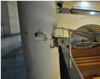
Pillares con añadiduras que dañan la estructura.
