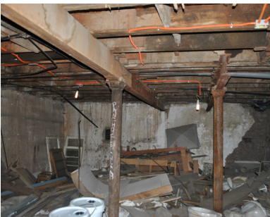
Escombros acumulados en subterráneo.
