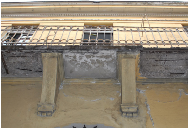
Balcón fachada oriente en mal estado.
