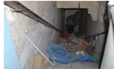
46. Escalera con acumulación de desechos
