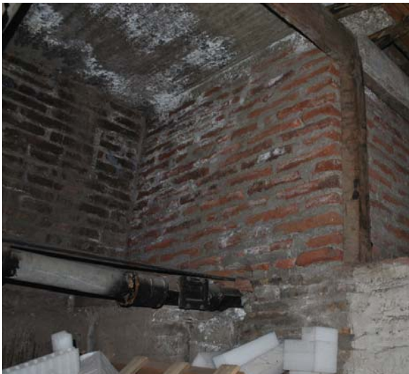
2.3. Humedades y Eflorescencias en muros y cielos.
