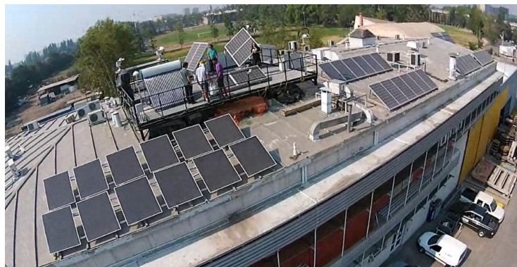
Figura 3.4: Planta fotovoltaica del Campus San Joaquín de la Universidad Católica.
