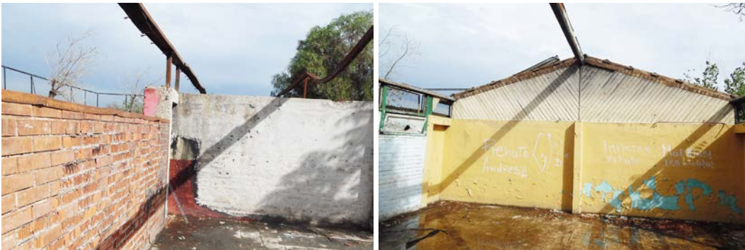
Pabellones destruidos por incendio Fuente: Elaboración personal, Junio de 2015
