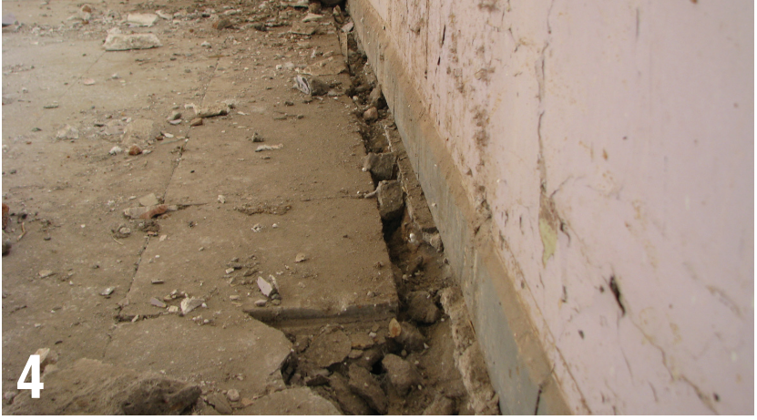
Grieta muro - losa
