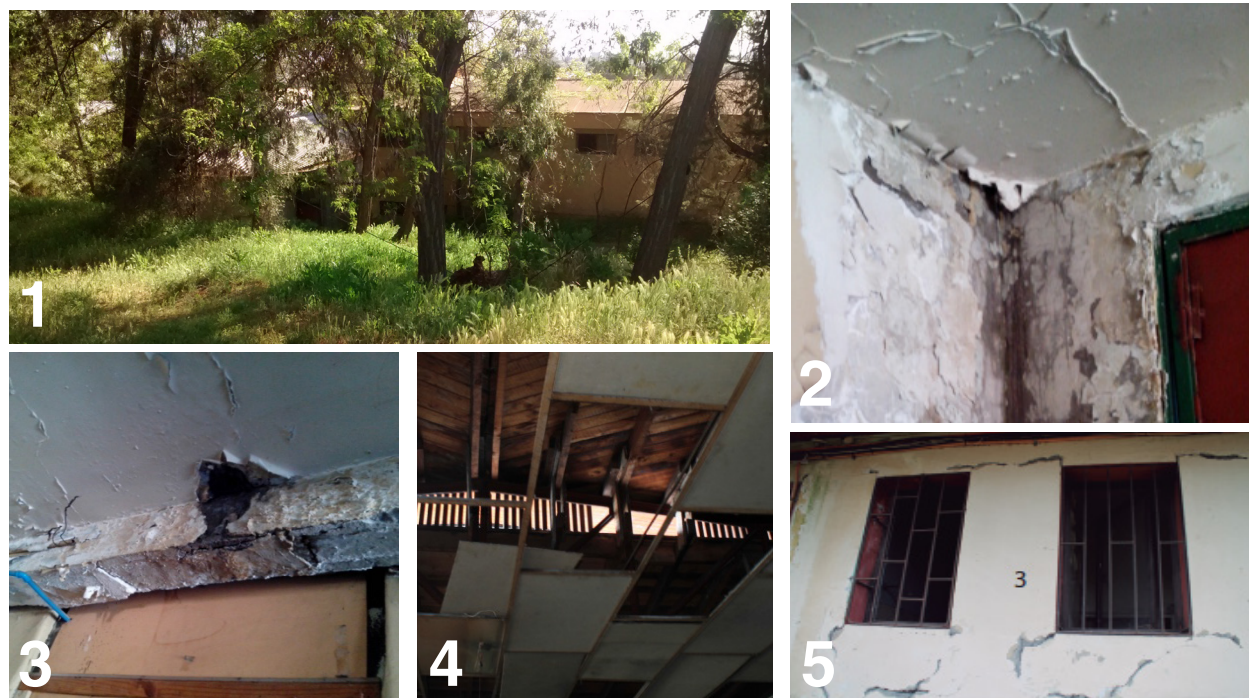
Figura 88: Daños estructurales en Pabellón 7. Fuente: Fotografías de Joselyn Ponce, 2014
