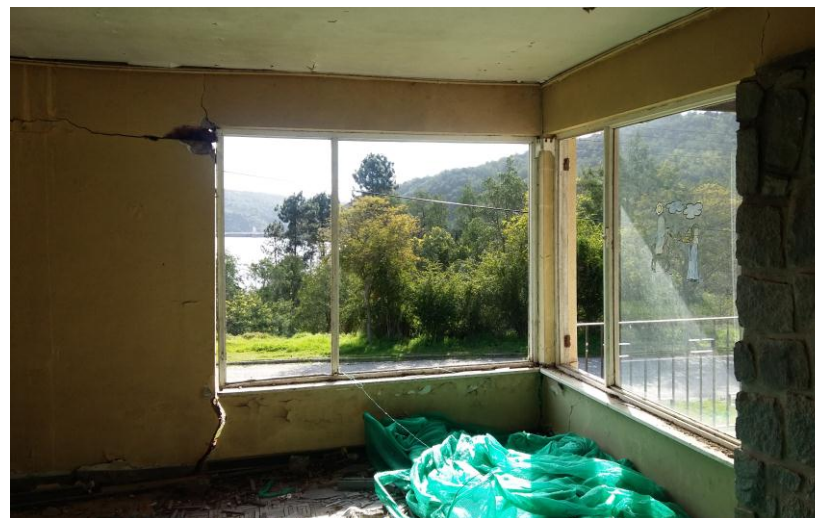
Vivienda con daño estructural severo producto del terremoto del 27 de febrero de 2010 (Fuente: Fotografía del autor)
