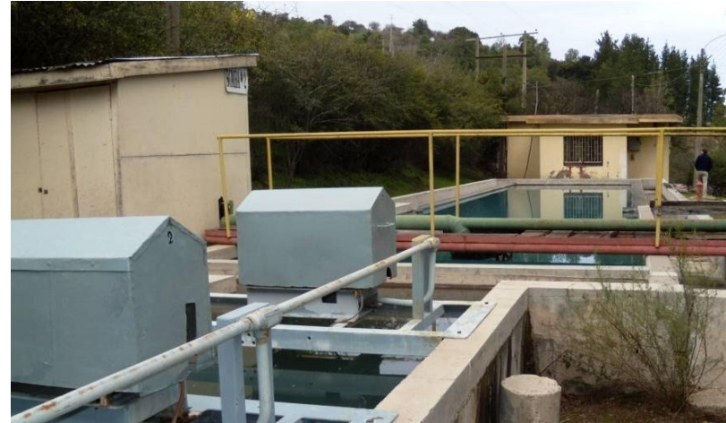
Planta de tratamiento de agua potable (Fuente: Fotografía del autor)
