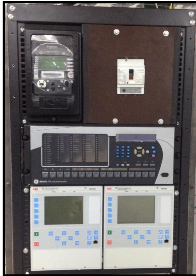
Figura 4.1. Disposición de los equipos en rack bastidor.
