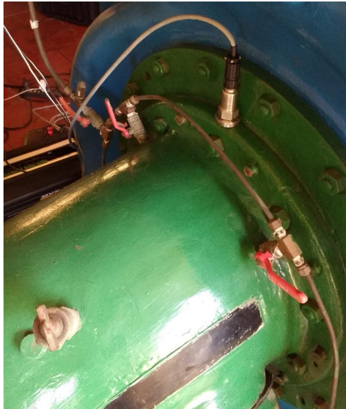
Figura 4-5 Acelerómetro instalado en la descarga de la turbina [Elaboración propia]
