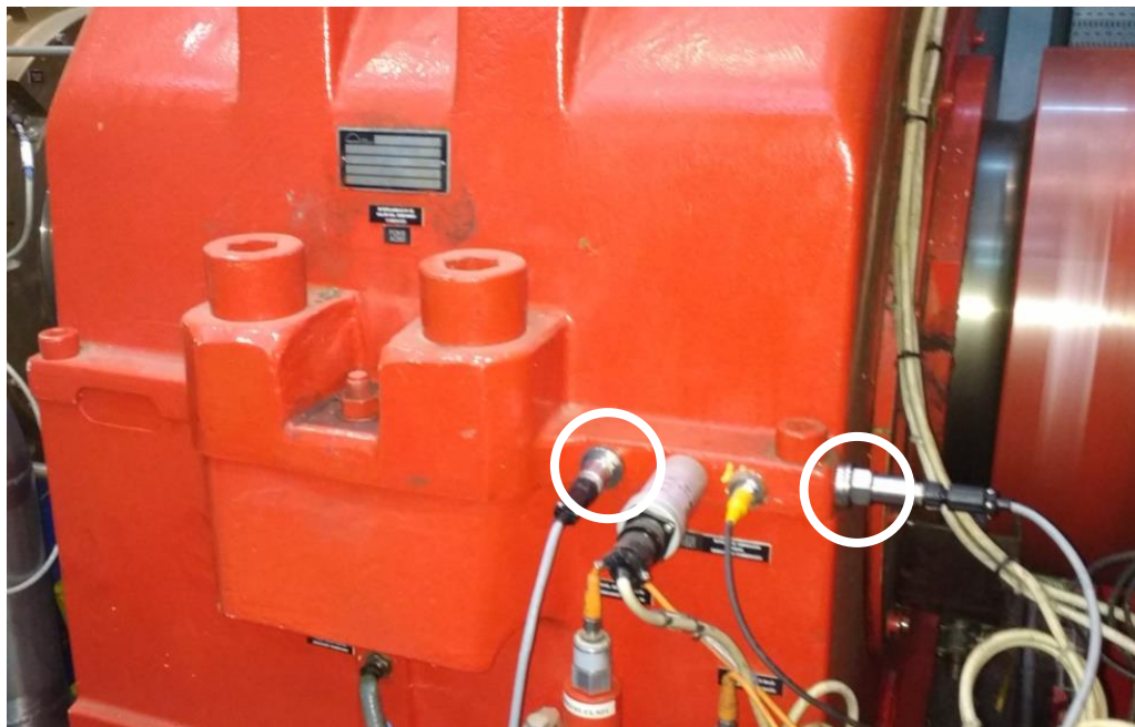
Figura 4-52 Instalación de sensores axial y radial en descanso combinado [Elaboración propia]
