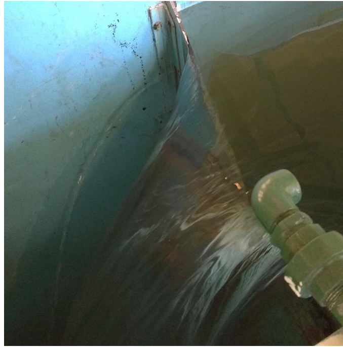
Figura 4-6 Vertedero en V para estimar caudal [Elaboración propia]
