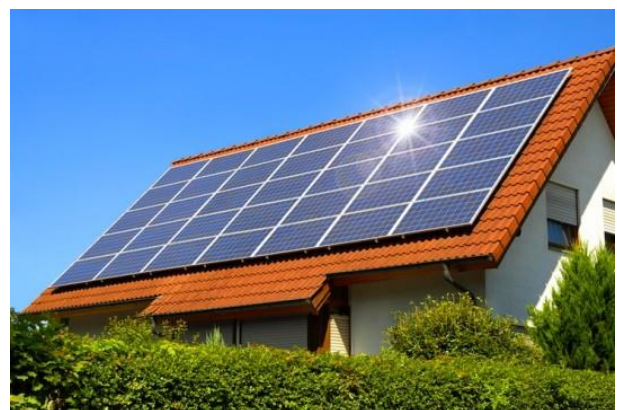
Sistema Fotovoltaico sobre techo inclinado. Fuente: www.powertracsolar.com/solar-rooftop-2
