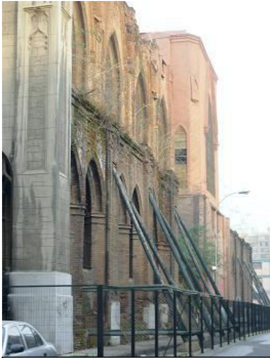
Los puntales a sus costados fueron puestos por la Municipalidad de Santiago para evitar el paso de los transeúntes
