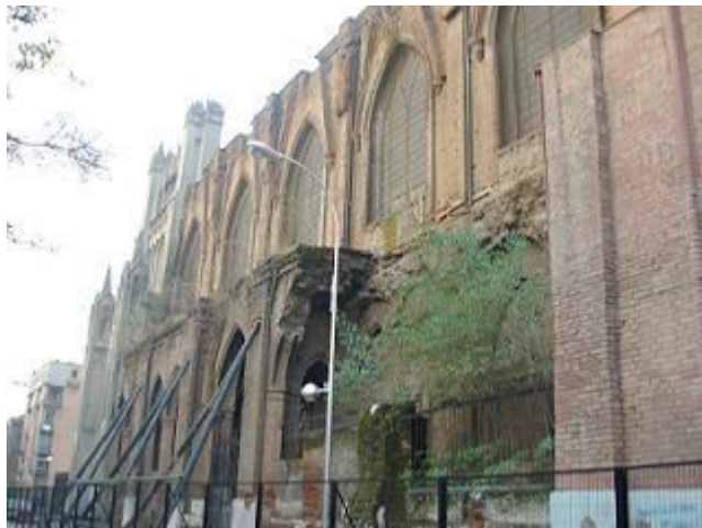
Los daños causados por el terremoto de 1985 fueron tan severos que, a pesar de las reparaciones que se hicieron posteriormente, se ordena el cierre del templo en el año 2000
