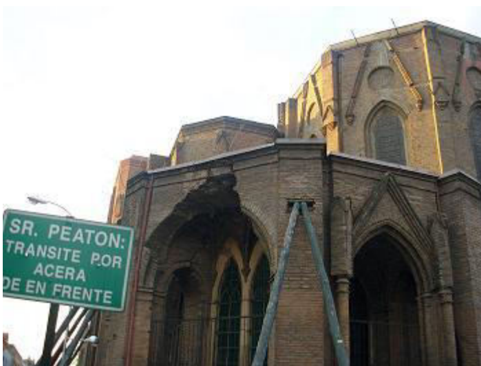
La basílica ha resistido los embistes de 12 terremotos a lo largo de su historia, pero el de marzo de 1985 marcó un antes debido a los graves y serios daños que causó en su estructura
