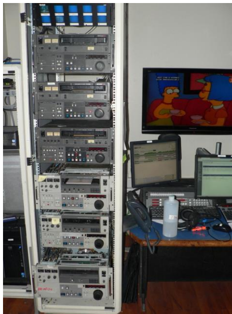
Fig. 14 Rack de máquinas análogas en Ingesta de Ardome
