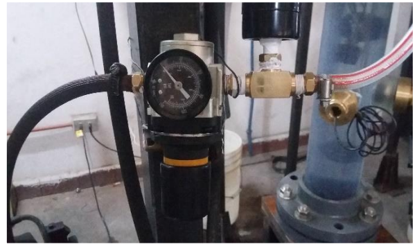
Figura 79: Manómetro-válvula de presión de trabajo.
