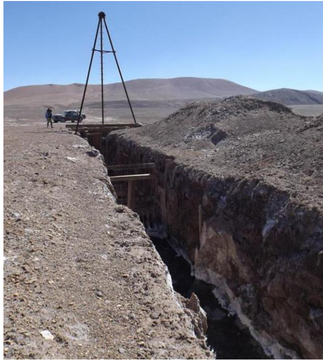
Figura 2.4 Canal artificial que conecta la cuenca del río Salado con la del salar de Pedernales.
