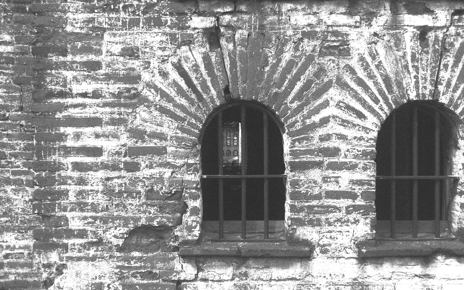
Detalles de vanos y materialidad de la Ex Cárcel de San Fernando Fuente: Gendarmería de Chile
