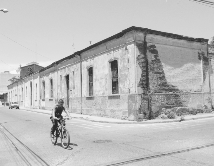
Fig.4 Deterioro de la Ex Cárcel de San Fernando. Fuente: Elaboración propia
