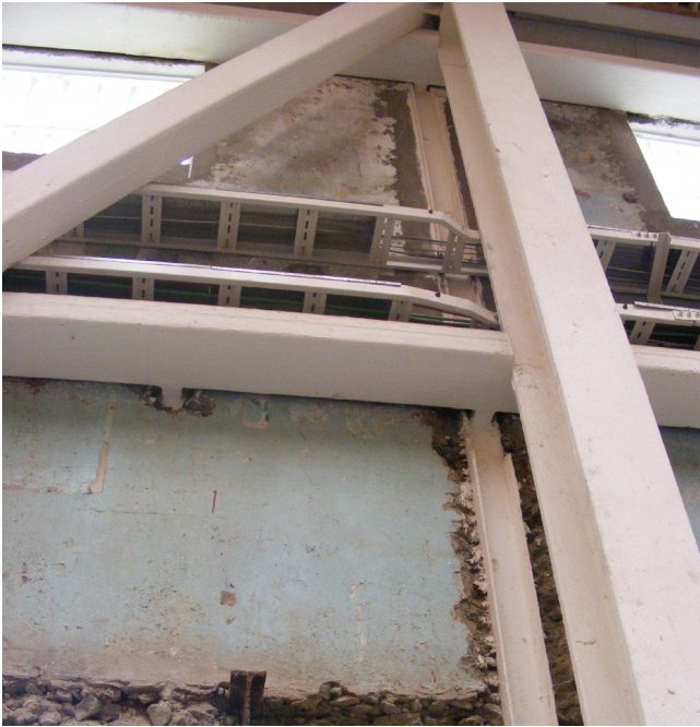
Fig.60 Detalles de refuerzo estructural en la Parque Cultural Ex Cárcel de Valparaíso y Palacio Pereira. Fuente: Elaboración propia
