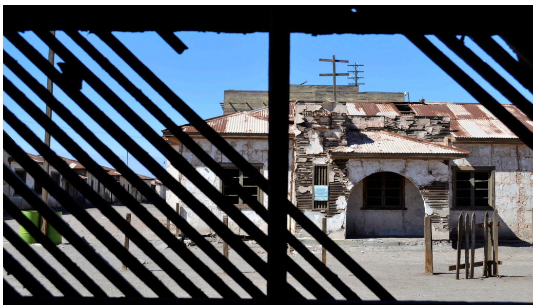
Deterioro de las construcciones al interior de Humberstone
