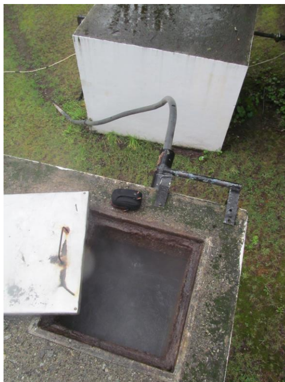
Figura 2-15: Estanque al cual llega el agua utilizada en el complejo turístico Río Liquiñe. El agua proviene de una tubería (parte superior de la fotografía), la cual extrae el agua del lado oriental del río Liquiñe.
