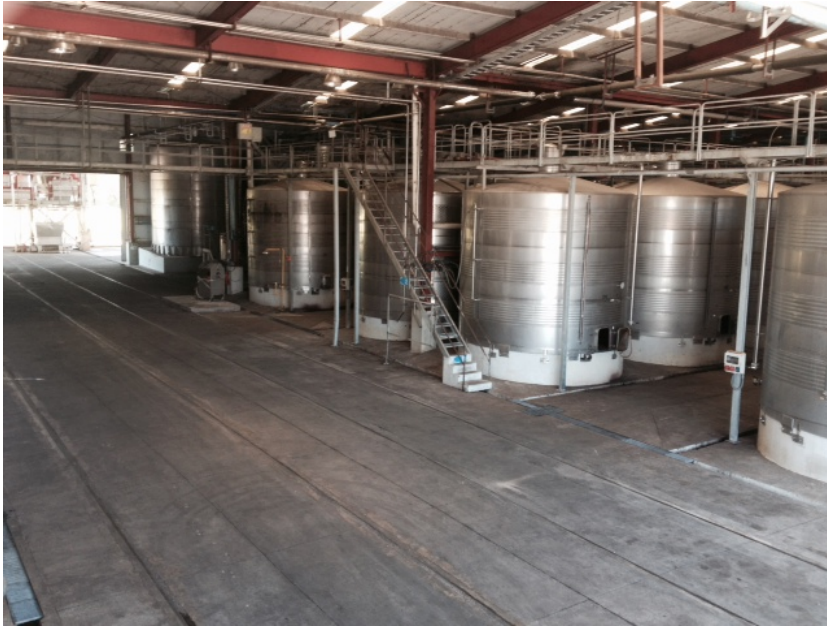
FIGURA 13: Foto cubas de decantación.
