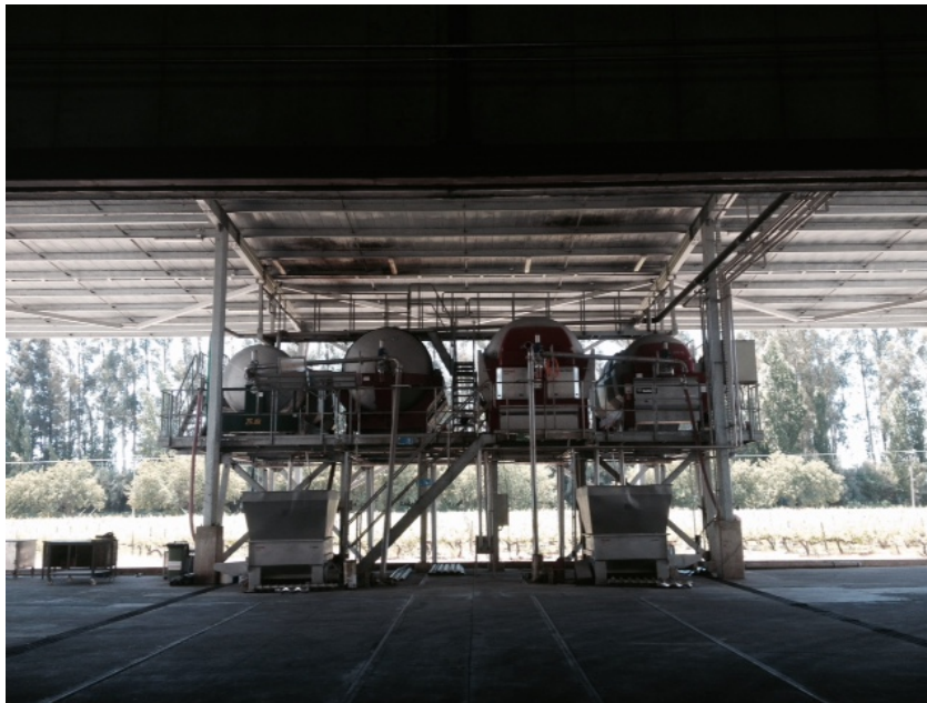
FIGURA 12: Foto batería de prensas.
