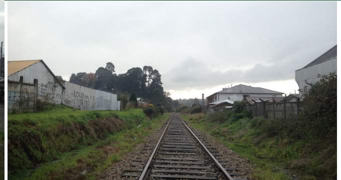
Tramo 10-12. Se observa la parte de atrás de las fotos anteriores, y el estado de abandono de las vías. Vista sur-norte.
