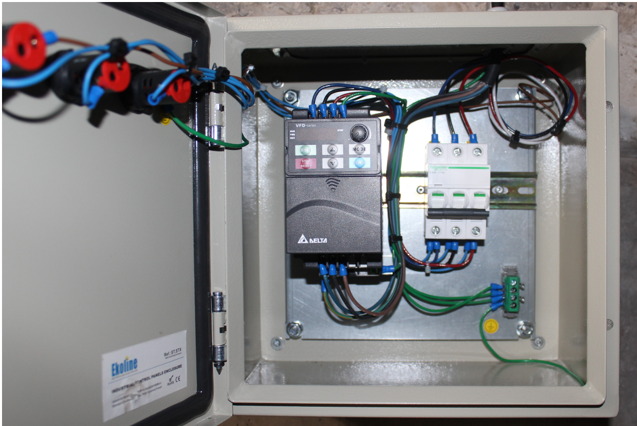
Figura 3.14: Fotografía del variador de frecuencia instalado en el Laboratorio Francisco J. Domínguez.
