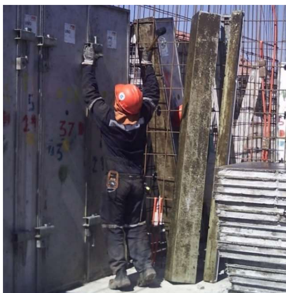
Imagen 9: Tarea de Montaje de Paneles de Muro Interiores por Maestro de Primera.
