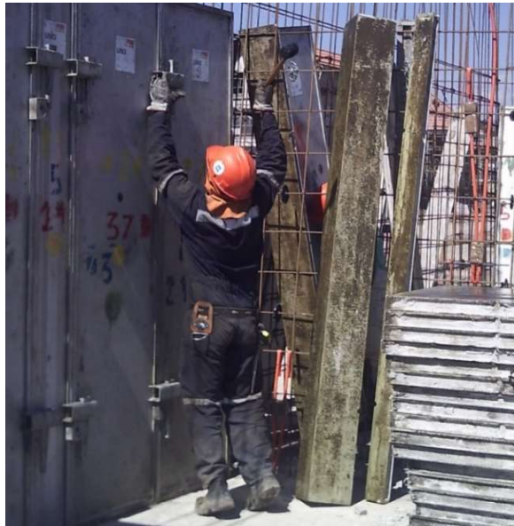
Imagen 5: Tarea de Montaje de Paneles de Muro Interiores por Maestro de Primera.
