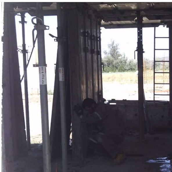
Imagen 20: Tarea de Descimbre de Paneles de Muro Interiores por Maestro de Primera.
