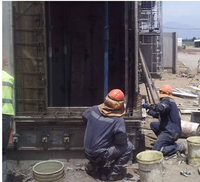
Imagen 11: Tarea de Montaje de Paneles de Piezas Especiales por dos Maestros de Primera.
