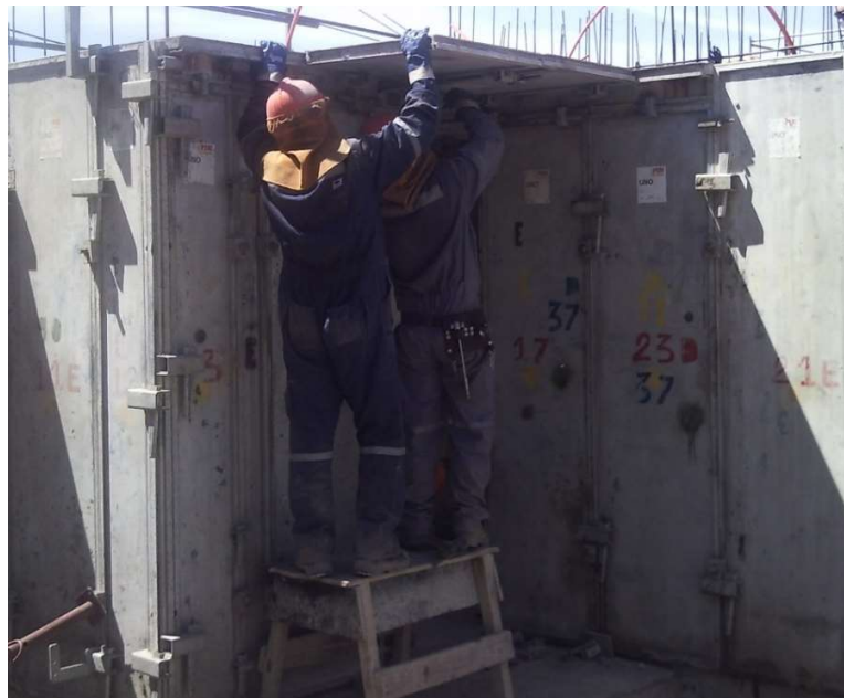
Imagen 12: Tarea de Montaje de Paneles de Losa por dos Maestros de Primera.
