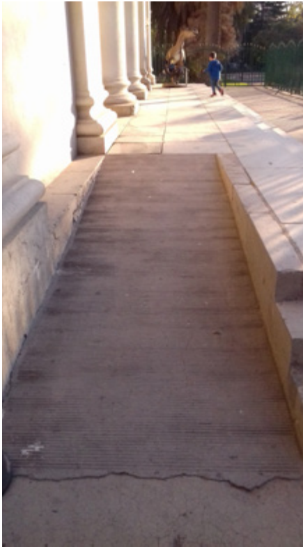
Foto 24. Ejemplo de rampa en mal estado y sin pasamanos
