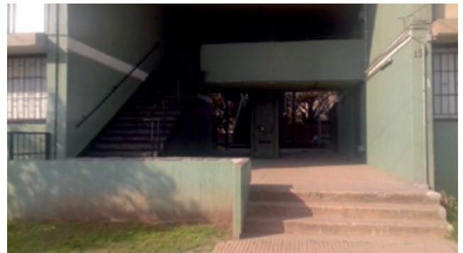
Foto 1. Entrada a block 2 sin entrada accesible
