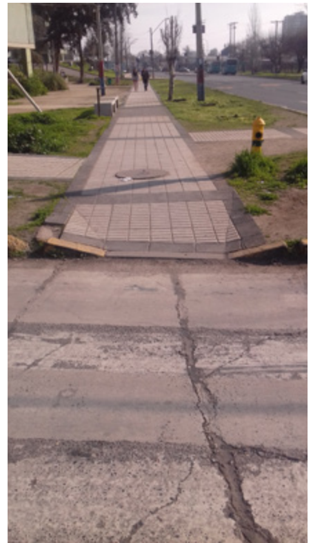
Foto 18. Cruce peatonal en mal estado
