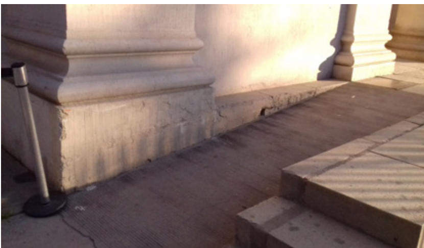
Foto 35. Ejemplo de rampa sin pasamanos y cambio de color en pavimento
