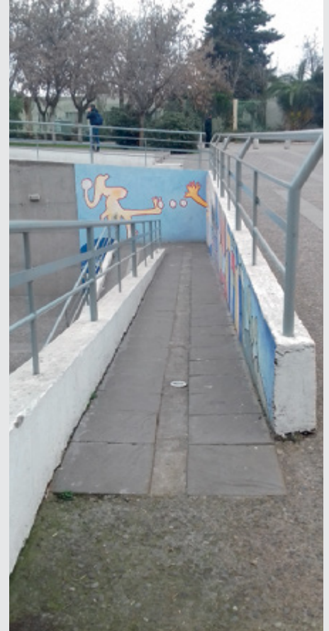
Foto 9. Rampa estrecha e inclinación superior a la recomendada
