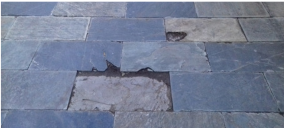
Foto 28. Detalle de sendero en mal estado
