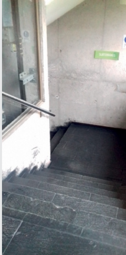
Foto 8. Escalera con peldaños deteriorados
