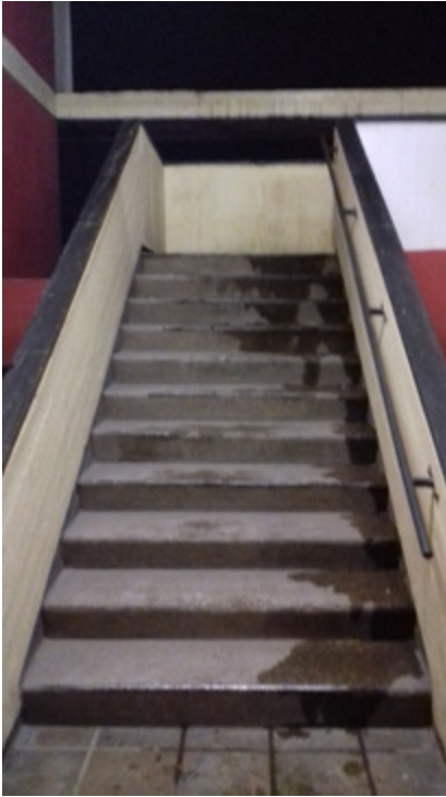
Foto 27. Escalera como acceso único a viviendas
