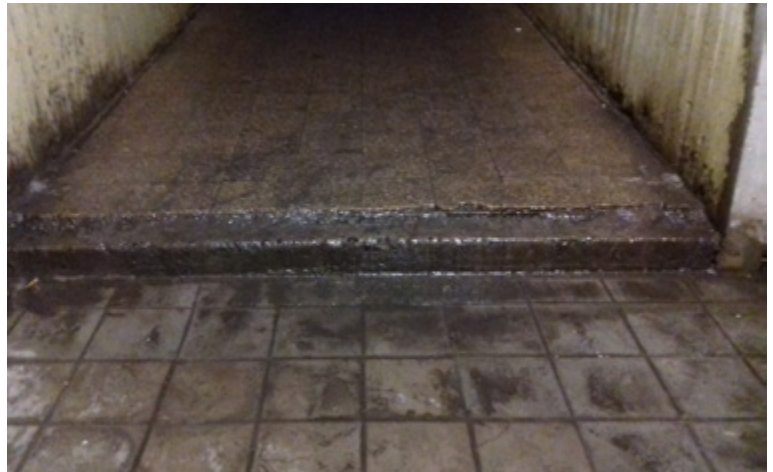
Foto 16. Escaño no señalizado en pasarela
