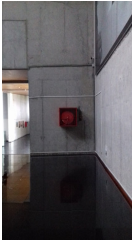
Foto 34. Manguera para incendios sobresaliente
