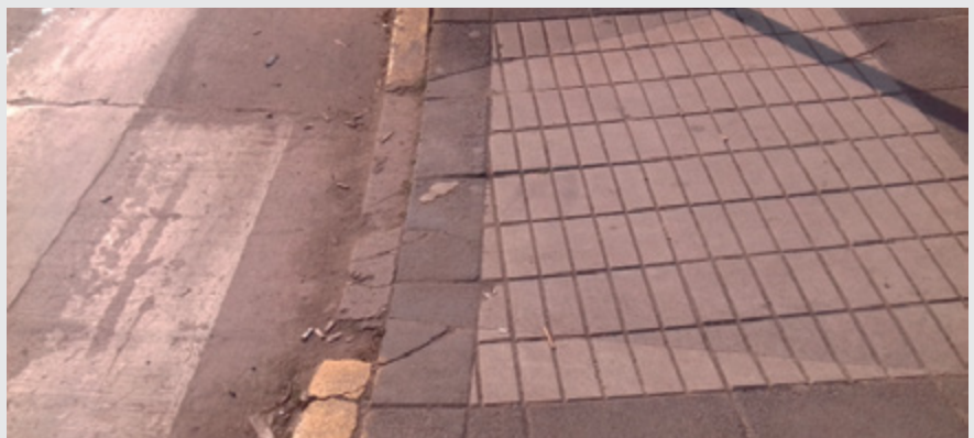
Foto 9. Rebaje de cruce en mal estado
