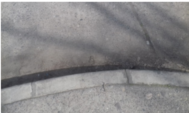
Foto 22. Cruce sin rebaje
