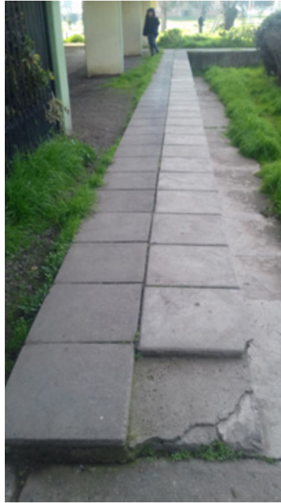
Foto 28. Escaño en mal estado y sin señalización
