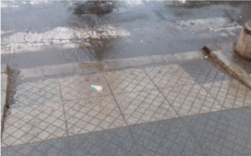
Foto 37. Ejemplo de cruce en mal estado y no accesible, entrada Lourdes.
