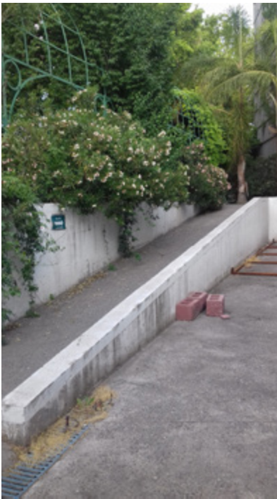
Foto 28. Rampa de acceso sin pasamanos
