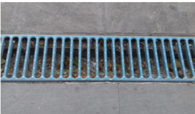
Foto 26. Rejilla de agua entrada
