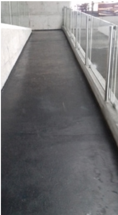
Foto 29. Rampa de acceso sin pasamanos
