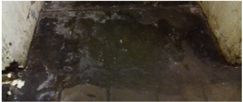
Foto 24. Ejemplo de pavimento en mal estado
