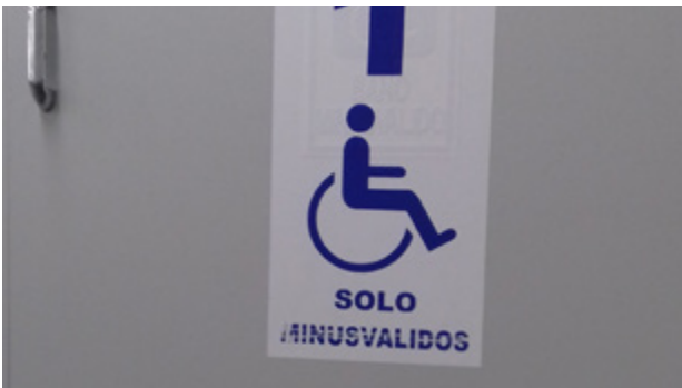
Foto 18. Señalización baño para personas con discapacidad. Uso de término incorrecto
