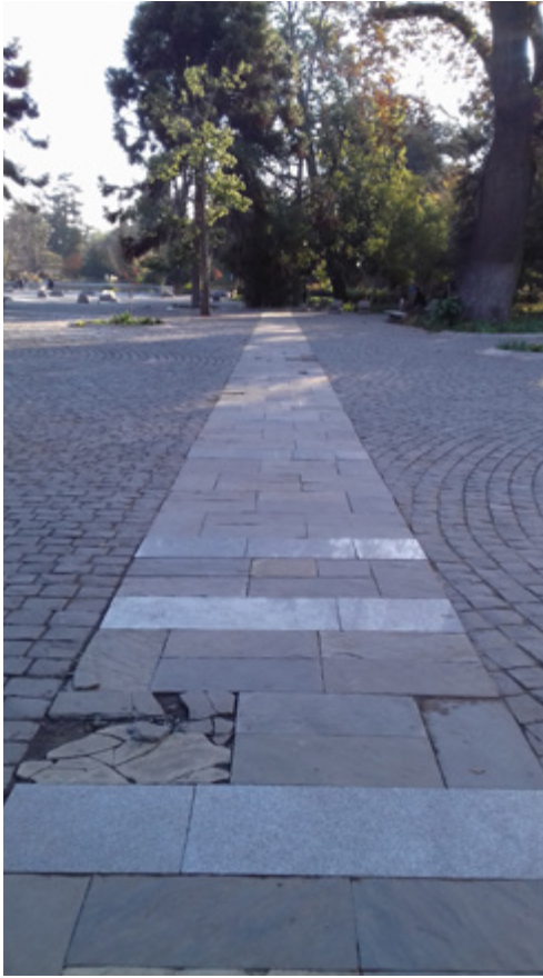
Foto 21. Ejemplo de sendero liso en mal estado
