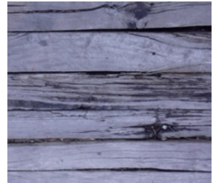
Foto 26. Detalle de madera en mal estado sendero adyacente a laguna
