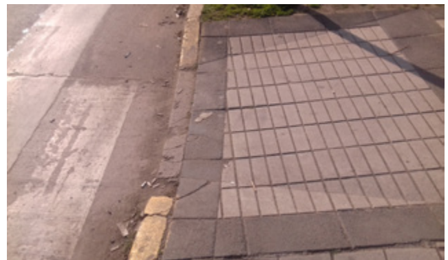
Foto 23. Cruce con rebaje en mal estado
