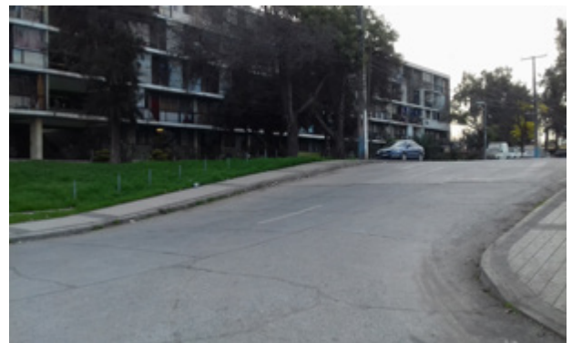
Foto 26. Calle y vereda con pendiente superior al 12% sin baranda
