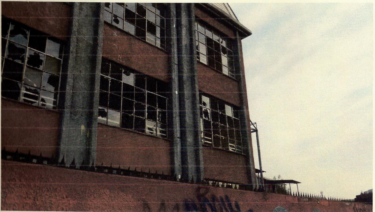
Parte de la estructura actual, deteriorada y en proceso de demolición según conversaciones con propietario.
