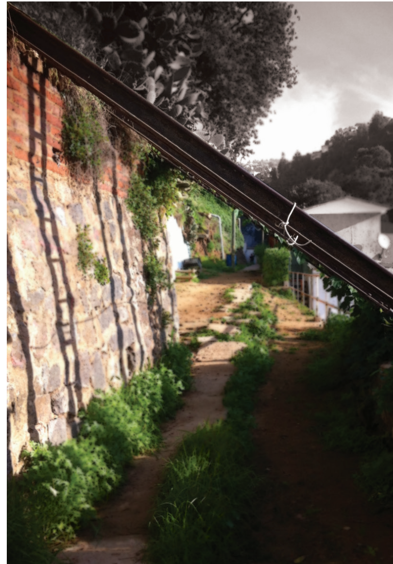
Figura 13. Imágen característica del sector; las trazas oxidadas y el verde musgo. Fuente: Elaboración propia.
