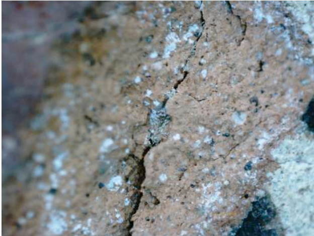
Figura 91.- Detalle de fisuras y subfluorescencias blancas en zona delaminada. (Fotografía: M. Dinator, Archivo CNCR).
