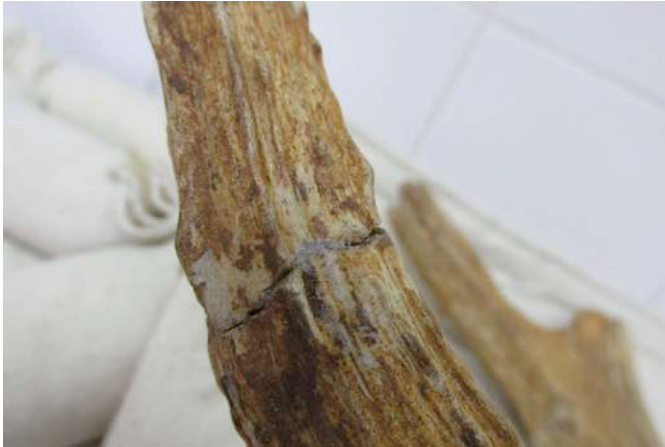
Figura 309.- Detalle de refuerzo en rama superior de garceta. (Fotografía: M. Dinator, 2017. Archivo CNCR).
