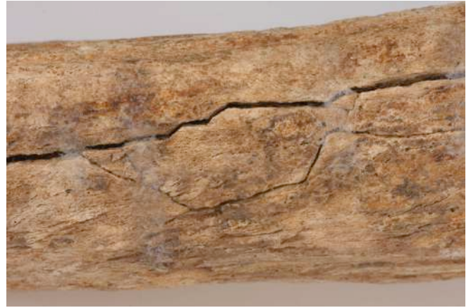
Figura 478.- Detalle de zona en borde posterior agrietada y con fragmentos desprendidos después de la intervención (Fotografía: L. Ormeño, 2017. Archivo CNCR).
