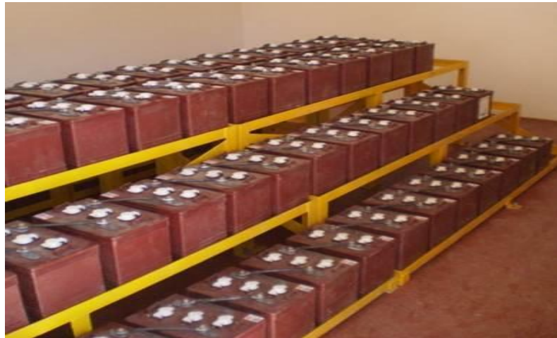
Figura 3. Banco de baterías, ubicado en Huatacondo. Fuente: CE-FCFM (2013).
