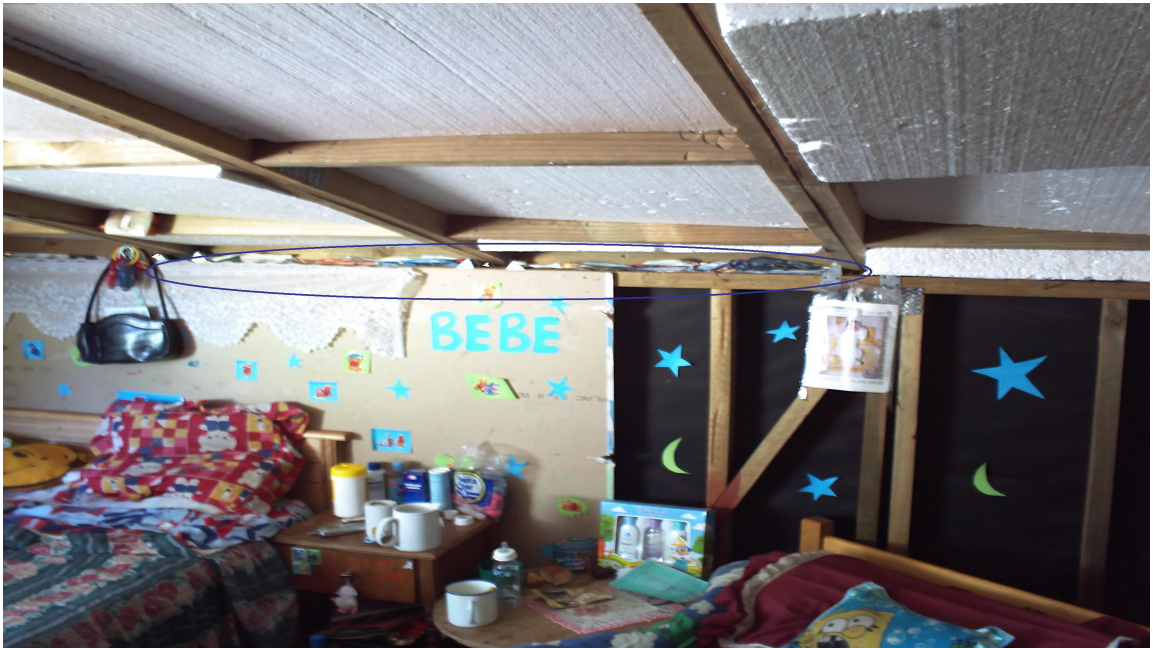
Figura 3.5: Control provisional del exceso de renovaciones de aire en el segundo piso de las viviendas sociales SCMI
