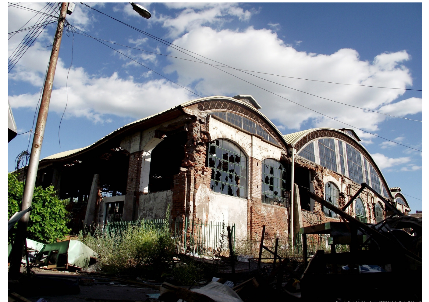
Imagen 3.2-14 Estado de abandono del edificio, año 2015.
