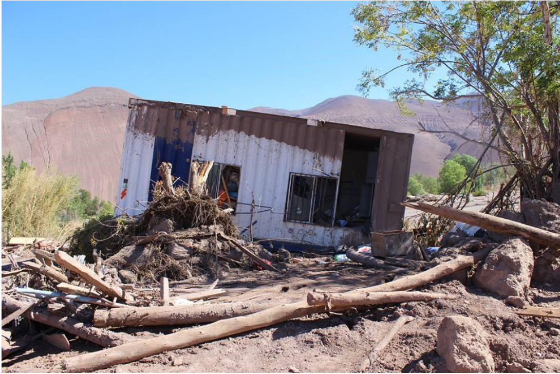
7. Container habilitado como dormitorio en La Capilla, los hombres dormían en estos módulos y las mujeres en construcciones livianas de las que no quedaron rastros. Foto: Yoselin Fernández
