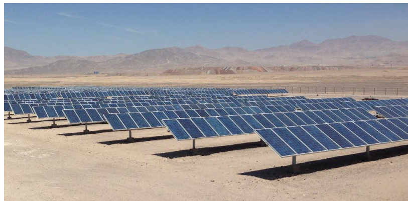
Figura 19. Arreglo de paneles en planta de generación fotovoltaica.
