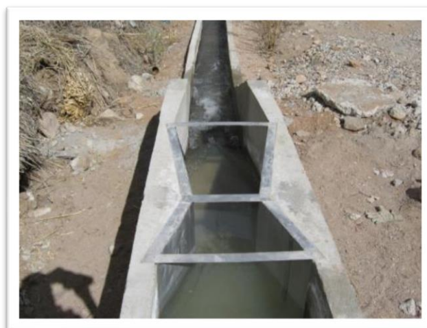
Fotografía 8 Aforador y canal Conay
