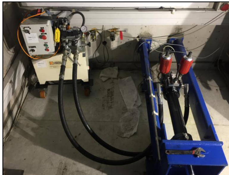
Figura 3.26. Conexión entre bomba hidráulica y actuador de la mesa vibratoria
